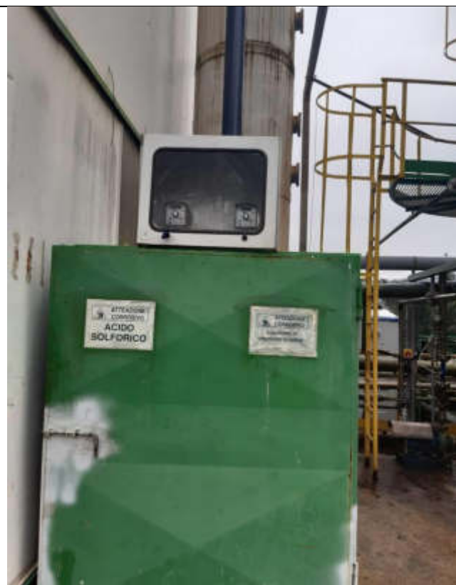
Display del dosaggio soda e acido cloridrico per scrubber E1 - non in funzione al momento del sopralluogo
