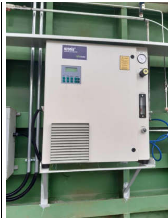
Impianto di ozonizzazione in funzione
