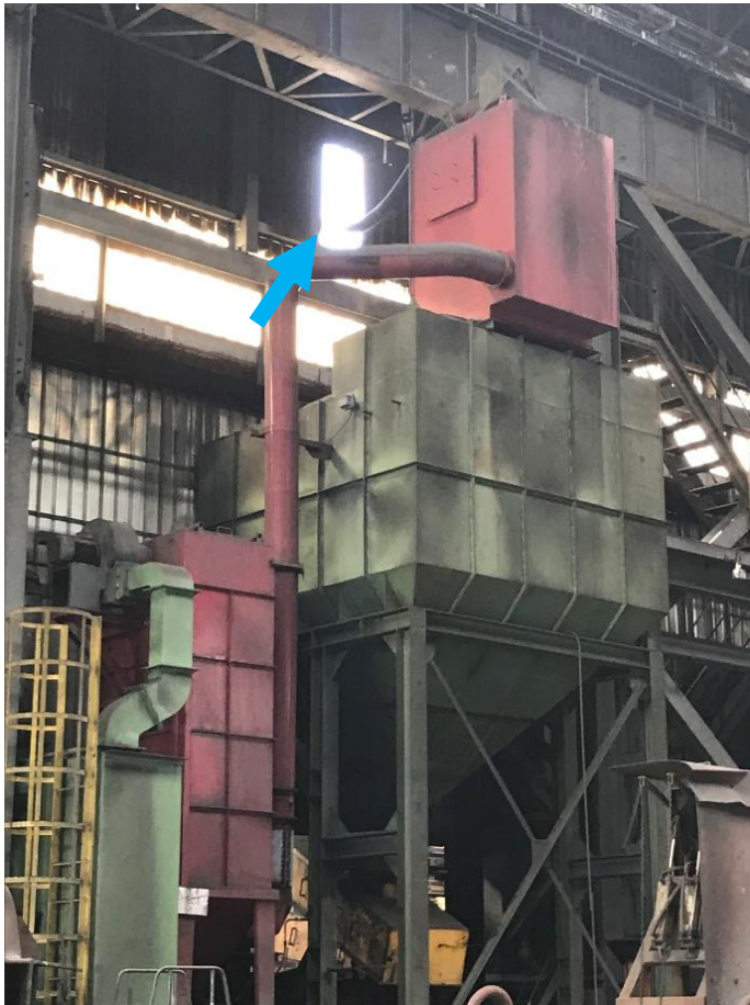
Figura 1: Emissione E27; la freccia azzurra indica l'apertura dal capannone verso il tetto; si ritiene debba essere chiusa e così mantenuta.
