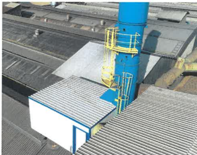
foto 9 – particolare cabina silente ventilatore E3
