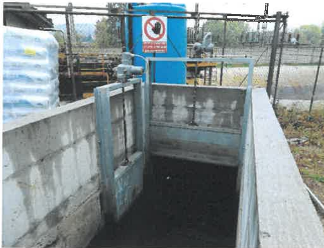
foto 5 – particolare vasca separazione saracinesche deviaflusso
