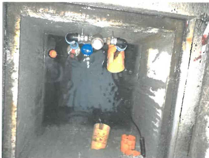
foto 6 – particolare pozzetto campionamento acque reflue industriali
