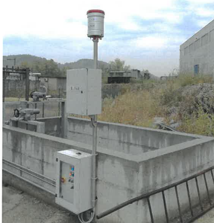
foto 4 – particolare vasca separazione con centralina pluviometrica
