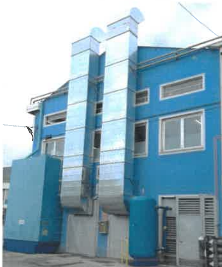
foto 10 – particolare insonorizzazione ventilazione sala compressori 1 (tubazioni)
