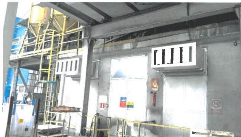
foto 11 – insonorizzazione cabina trasformatori forni (silenziatori a setti)
