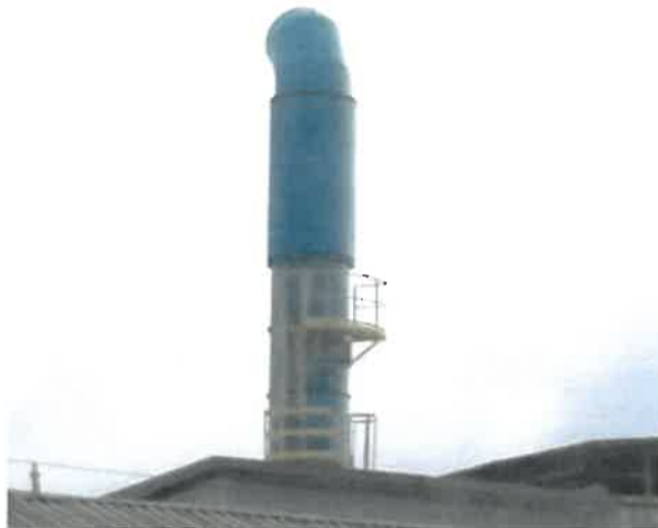
foto 8 – particolare silenziatore camino di scarico E3
